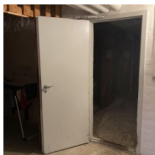
Brandadskillende dør i kælder.
