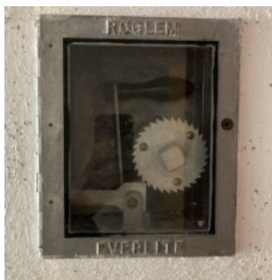
Røglem udløser i opgang A.
