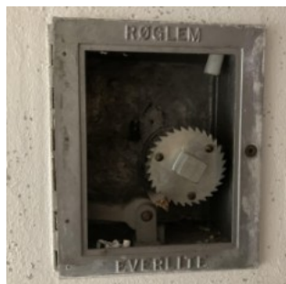
Opgang B, røglem udløser.
